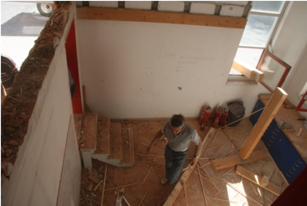
Im Bereich des bisherigen Flachdaches im 1. OG entsteht der neue Jugendraum als Zubau zum bisherigen Vortragssaal.
